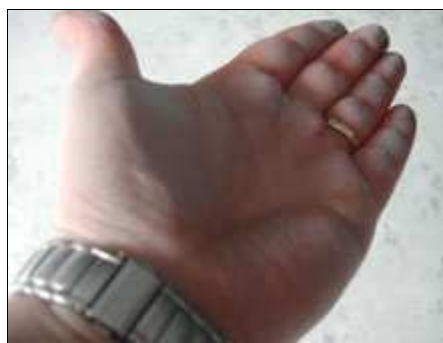
Afb. 1 De stofafgifte kan vastgesteld worden door met de hand over het betonoppervlak te gaan.
