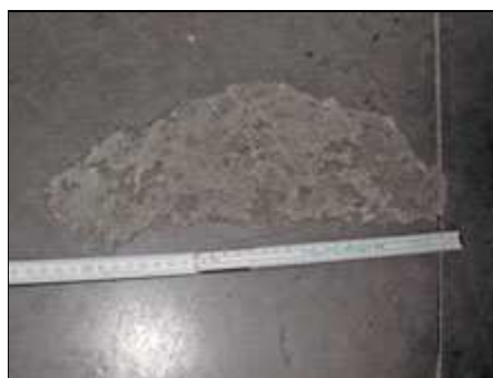
Afb. 4 Loskomen van de slijtlaag van een betonvloer.
